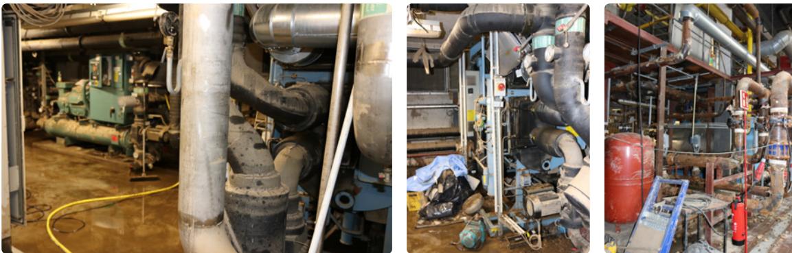
Die Energiezentrale im zweiten Untergeschoss nach der kompletten Zerstörung durch die Wassermassen.
