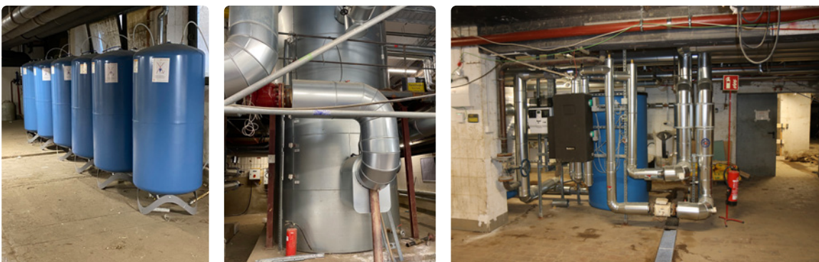
Die Versorgung mit Medien ist wieder sichergestellt.
